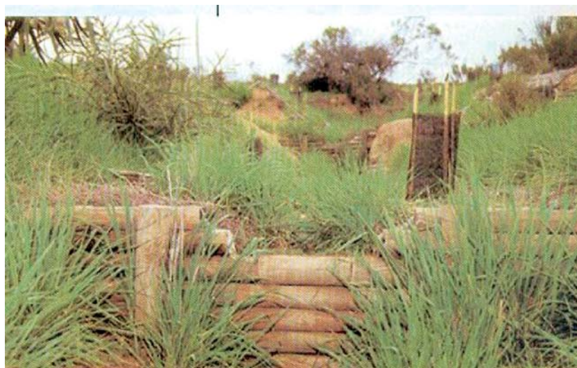
Disipadores de energía.
