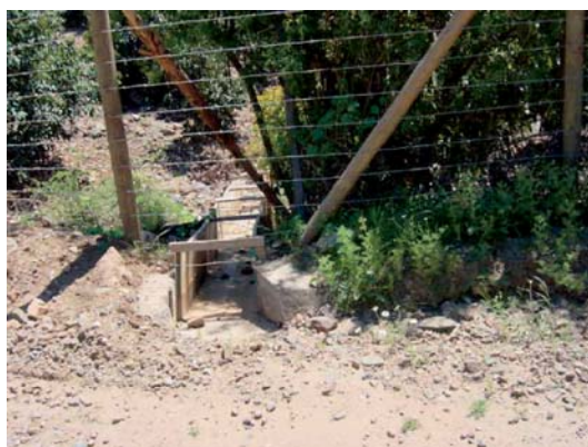
Conducción de aguas
