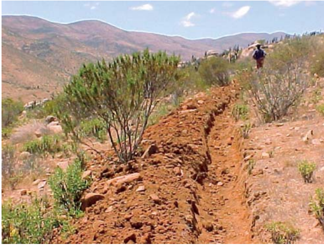
Zanja de desviación aguas arriba.
